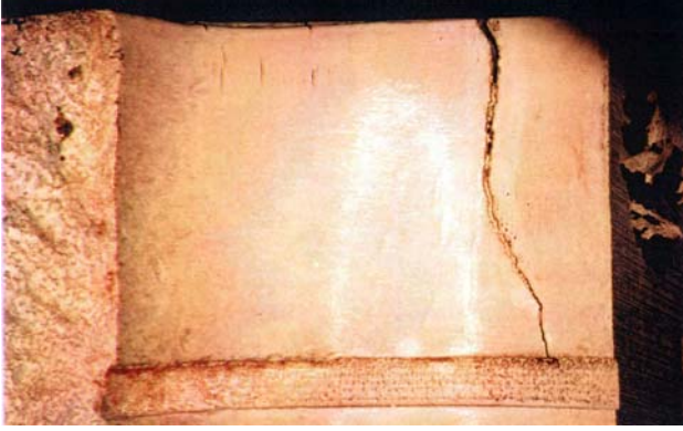
Slika 2. Glavna prslina na unutrašnjoj površini otvora za cev Figure 2 – Main crack on the inner surface of the tube hole
