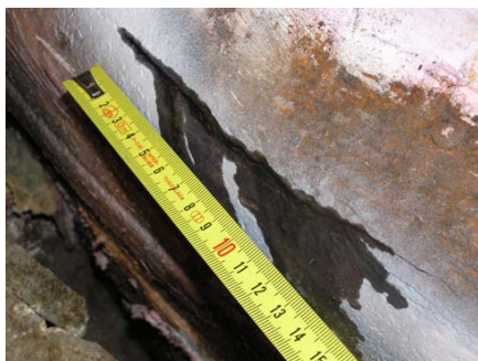
Slika 18. Prslina i lom posle korozije
