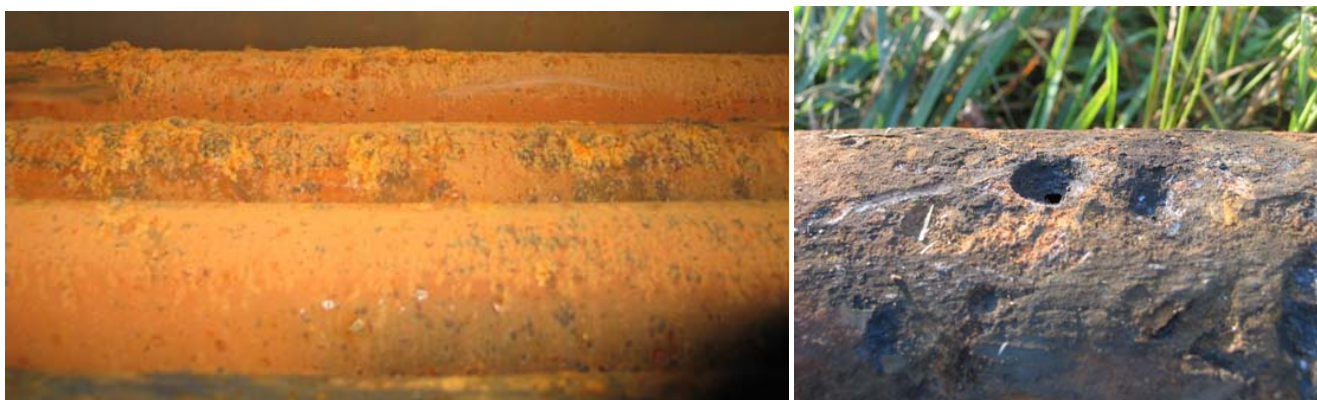
Slika 11. Talog i bubrežnje na vodenoj strani dimne cevi (levo) i konačno prošupljivanje (desno)
