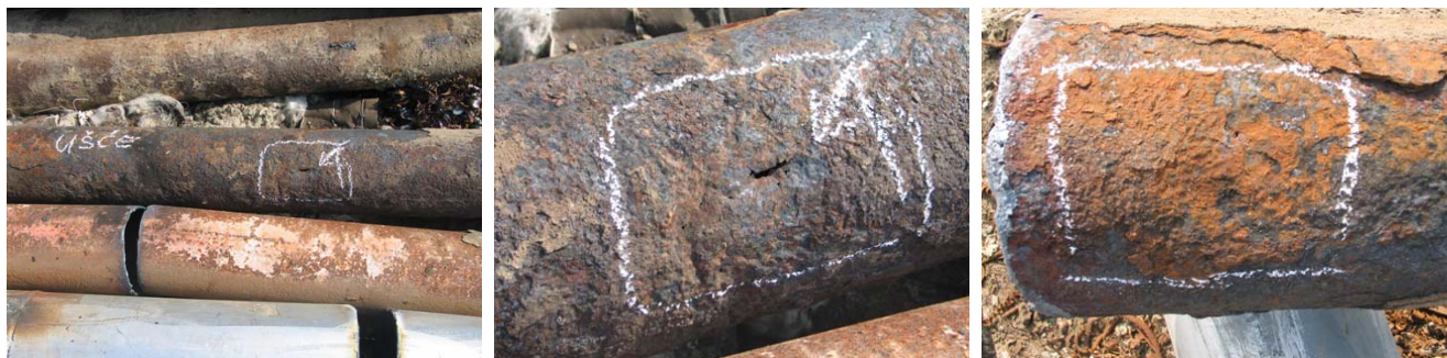
Slika 23. Izgled cevi oštećene atmosferskom korozijom sa spoljne strane (levo), proboj na cevi (sredina) i opšta korozija (desno)
