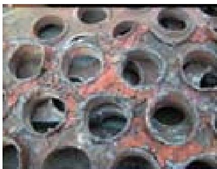
Opšti izgled oštećenja
