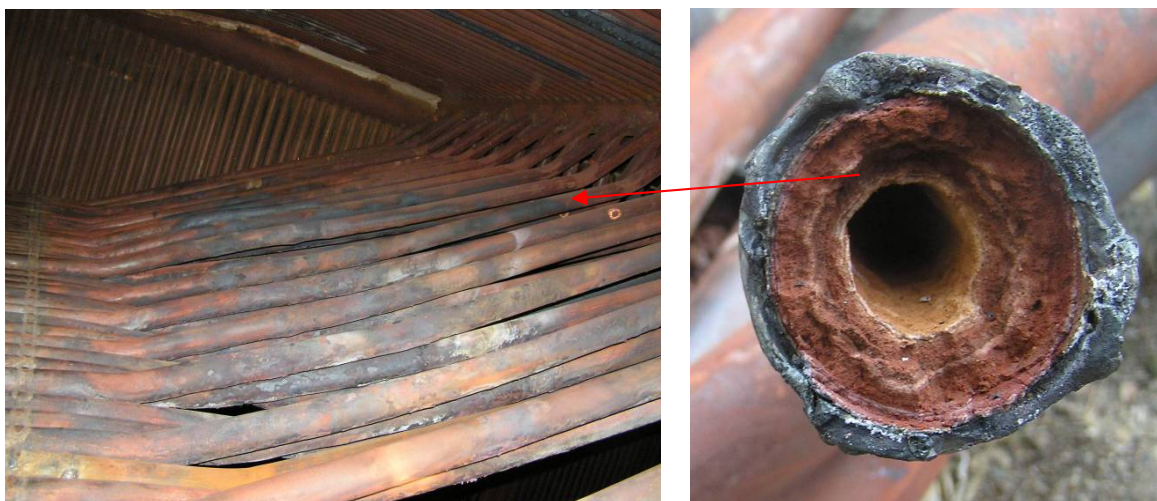
Slika 10. Pregorevanje u zoni cevi zavese, desno se vide naslage sa vodene strane, /6/
