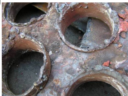
Prsline na zavarenom spoju cevi i ploče
