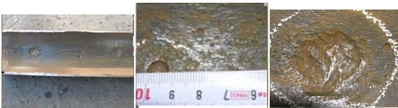
Slika 12. Stanjenje zida cevi sa unutrašnje strane na mestu kratera zbog kiseonične korozije
