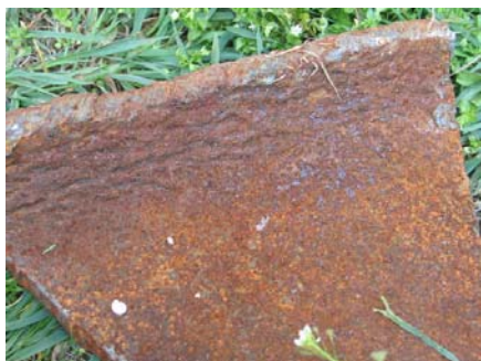
Slika 17. Korozija danca u vidu brazdi
