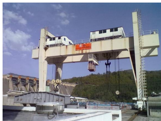
Portalni kran 2x250+63 t u RHE „Bajina Bašta“
