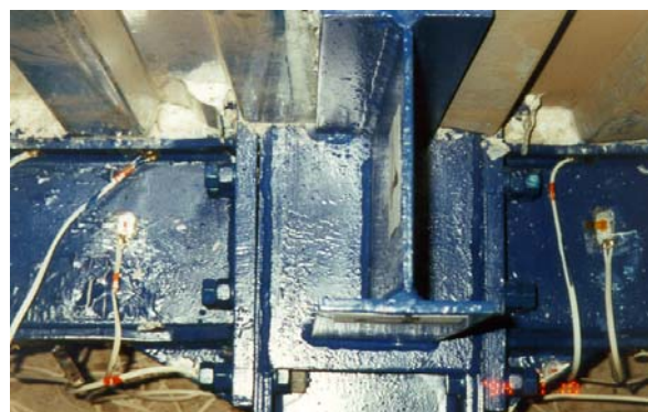
Figure 8. Plastic hinge in web at the end of the beam. Slika 8. Plastični zglob u rebu na kraju grede
