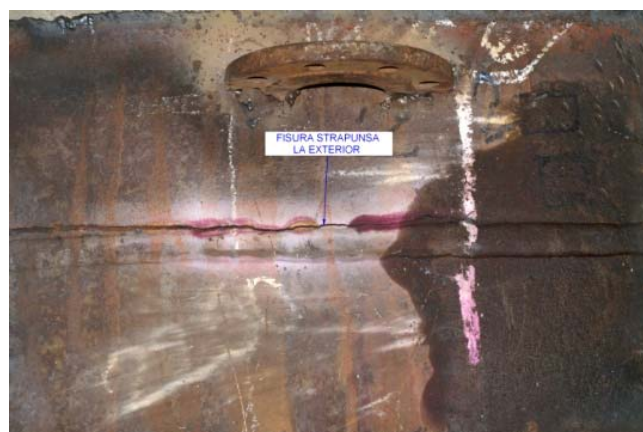
Figure 4. Coupon 2 – exterior view, with crack. Slika 4. Presek 2 – spoljni izgled, sa prslinom.
